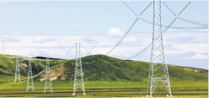
青海—河南±800千伏特高压直流工程
