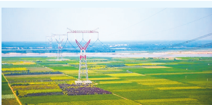
晋东南—南阳—荆门1000千伏特高压交流工程
