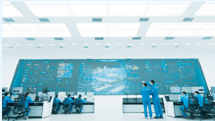
滨化股份智慧化工园区指挥中心
