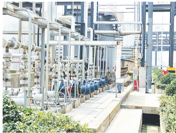
湖北鄂中生态农业科技有限公司厂区一角
