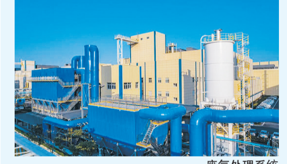
废气处理系统
