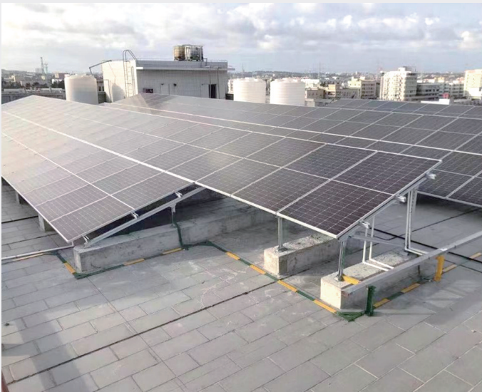
石狮晨光化纤染织有限公司屋顶分布式光伏电站 邱银炳/摄
