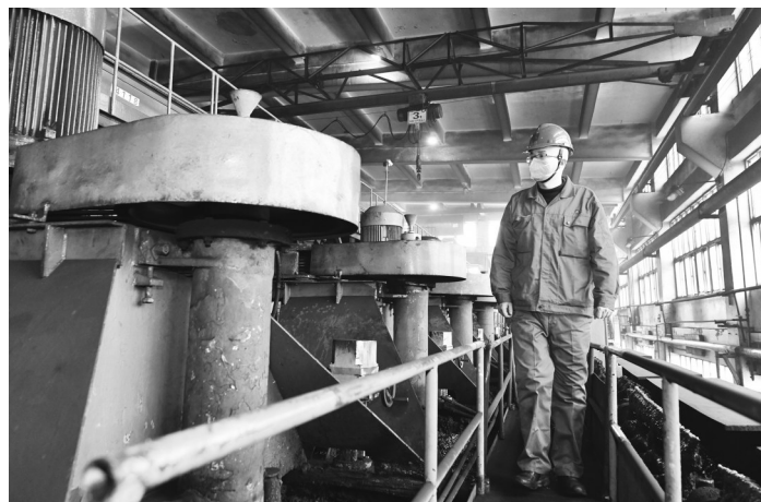
淮北矿业集团选煤厂岗位操作人员不间断巡视巡查洗选设备，确保安全生产。
