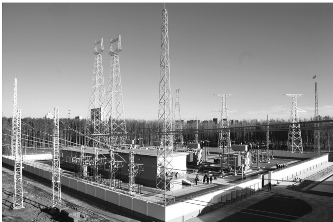
“京沈客专示范工程”——阜新牵引变电所
