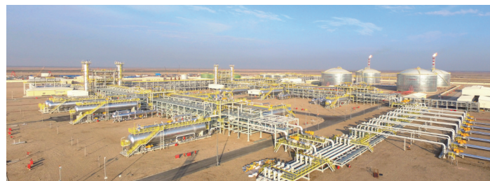
伊拉克哈法亚千万吨级集中处理站
