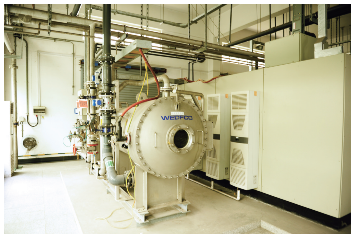
赛莱默 WEDECO 臭氧发生器及紫外消毒设备,有效解决了上海临江水厂水质中微生物的去除问题。
