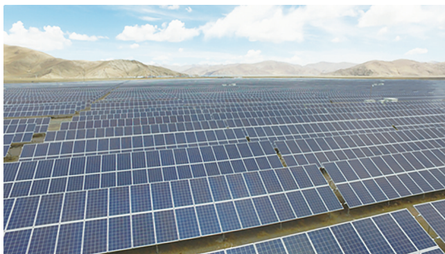
陕能榆阳50MW光伏电站光伏厂区
