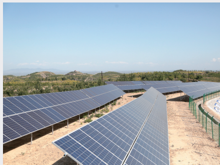
榆能集团在榆林建设的光伏电站
