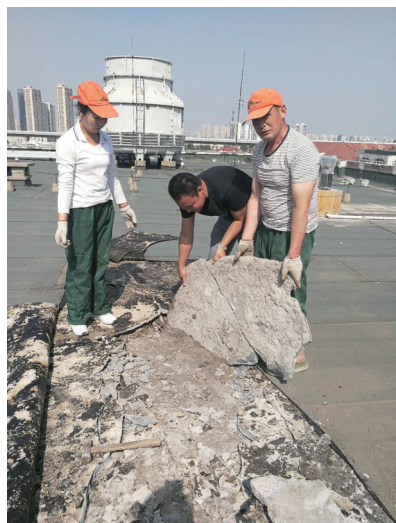
修复前的老旧建筑屋顶,最初铺设的防水材料已经腐烂导致漏水严重。
