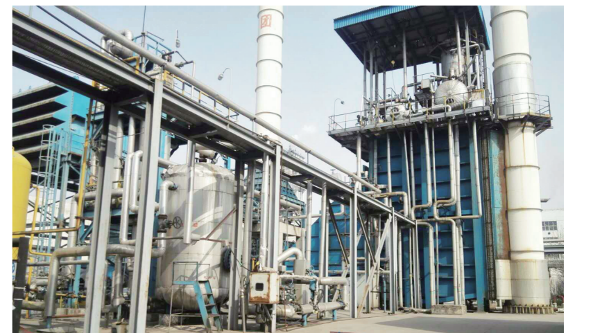
山西潞安集团采购1台(套)QD128燃气轮机机组，同时配套1台(套)余热锅炉，所产饱和蒸汽用于生产工艺。燃气轮机机组以合成化工尾气为燃料，采用了蒸汽回注技术，有效减少NOx排放量。目前机组累计无故障运行时间超过2万小时。
