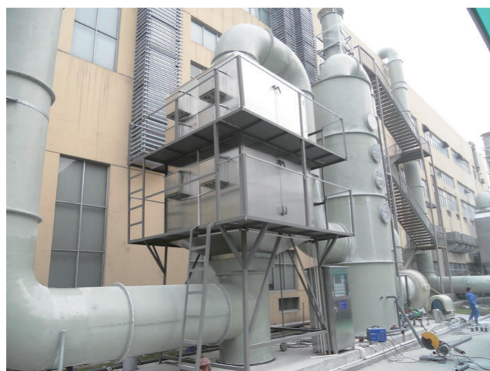
湖北武汉精羽管业生产车间废气治理项目
