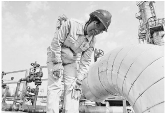
张恒珍在装置区巡检 柯裕清/摄
