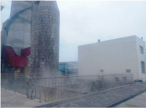
电厂脱硫系统
