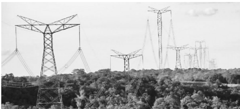
巴西美丽山水电送出特高压直流输电一期工程
