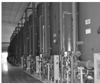
山东魏桥创业集团热电厂锅炉补给水处理项目
