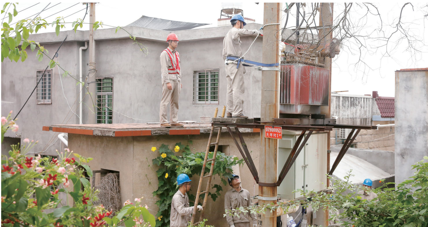
整改低电压台区,保障供电可靠
