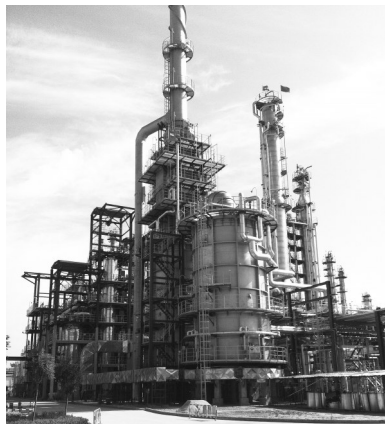
中国石油庆阳石化公司70万吨年催化汽油加氢脱硫装置
