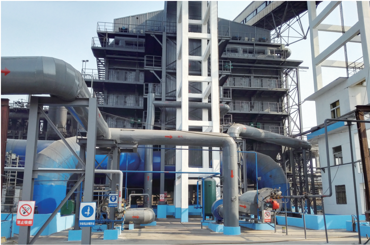
山东铁雄焦炉烟气脱硝工程
