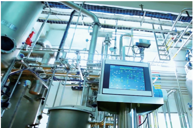
天士力中药提取液浓缩装备,集成数据采集、分析及监控平台,工艺运行轨迹数字化、可视化,实时预判浓缩终点
