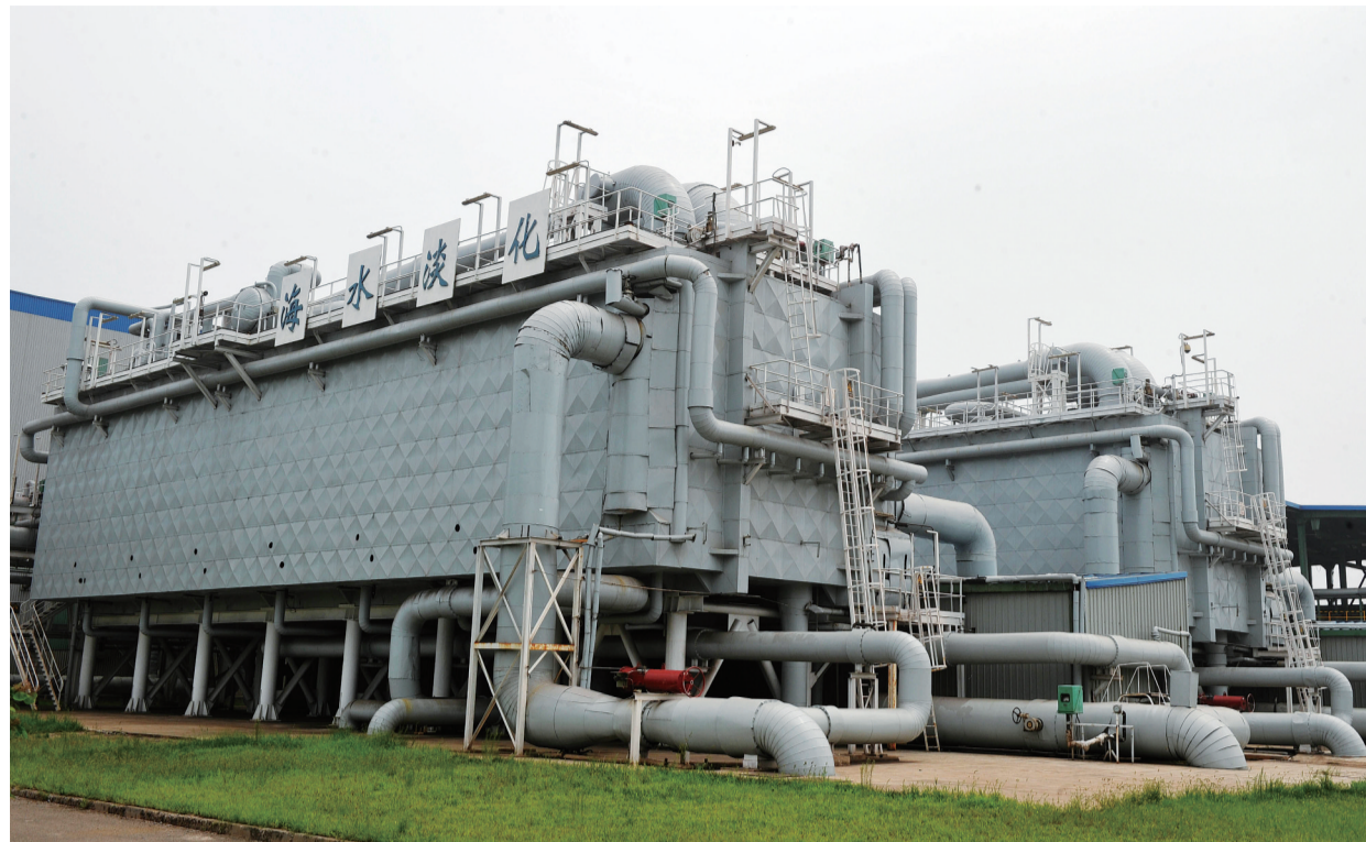
首钢京唐钢铁将生产过程中的余热、余压、余气充分利用,并应用于建成的大规模海水淡化装置,日产淡水达数万吨。图为中国首个循环经济示范区河北曹妃甸的首钢京唐钢铁厂海水淡化项目一角。
