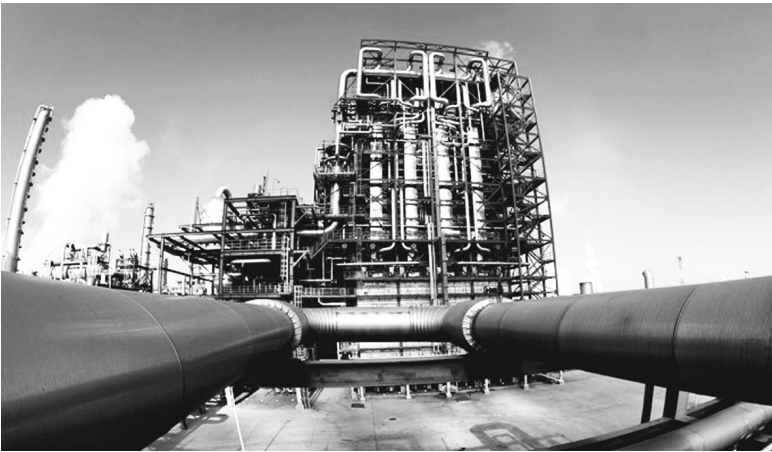
图为中国石化镇海炼化新增20万吨/年气体裂解炉雄姿
