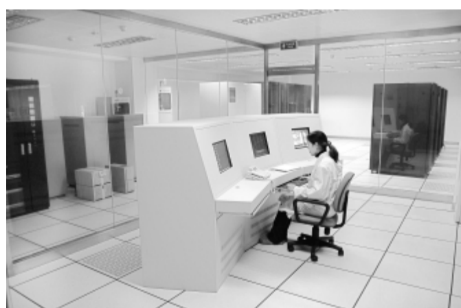
双汇集团数据中心
