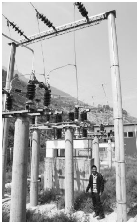
四级电站变压器
