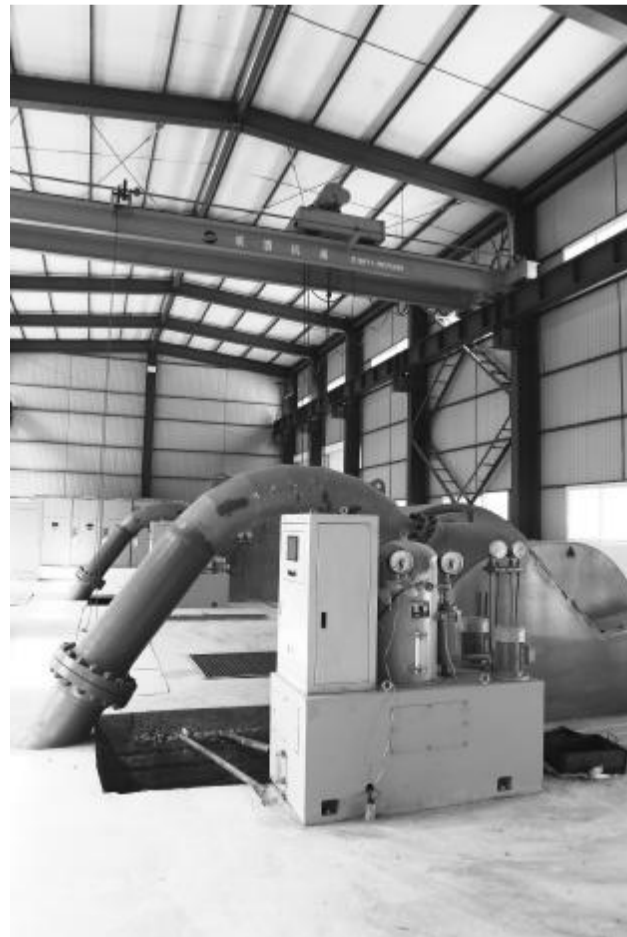
已经建成的依补河四级电站发电机房
