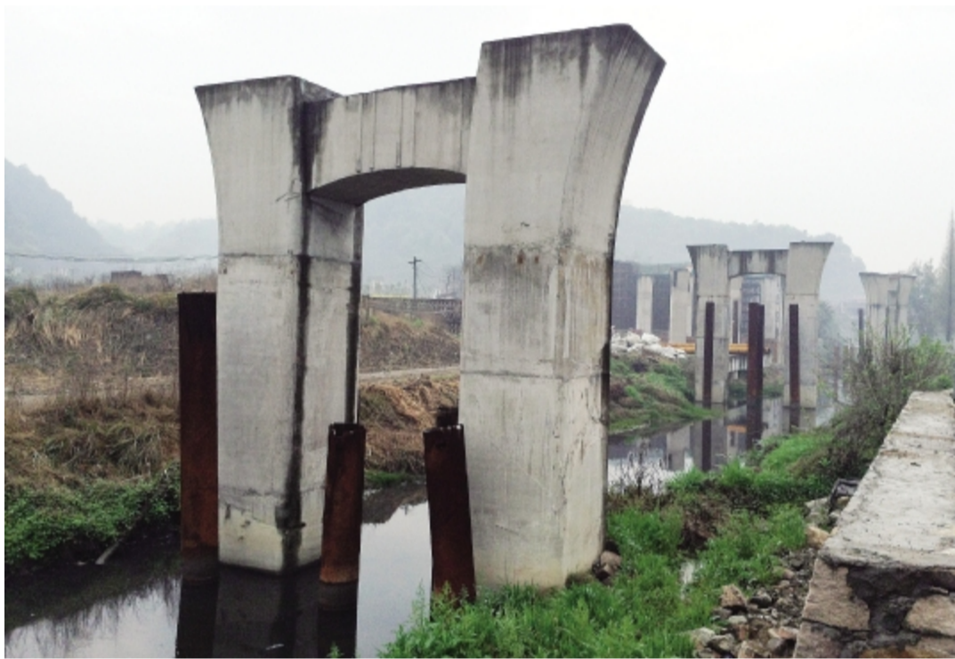
通过经济园的高架桥只有数个桥墩矗立在那里, 不少的裸露在外面的钢筋锈迹斑斑。作为经济园配套设施, 高架桥本该在 2009 年 10 月份通车, 但 3 年多过去了, 仍然未能建成。本报记者 张龙 / 摄
