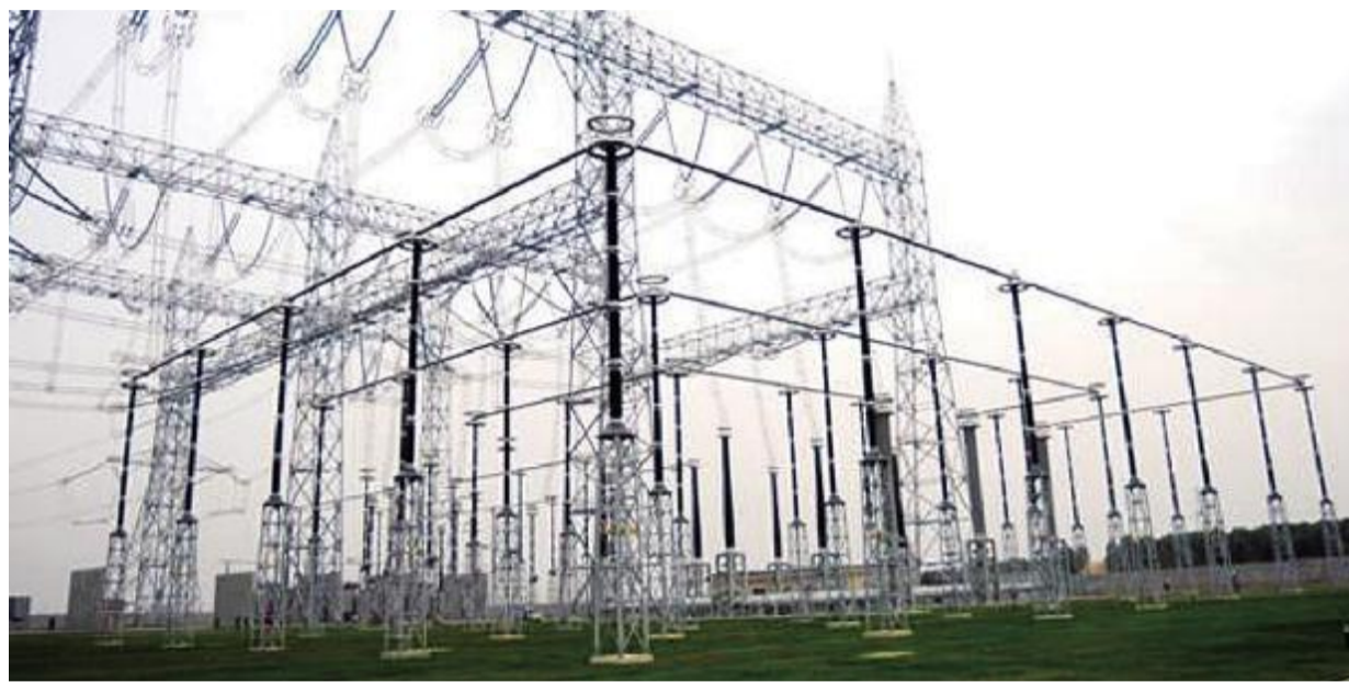
2007年研制成功世界首台1100kV16kN户外棒形支柱绝缘子已在荆门变电站运行
