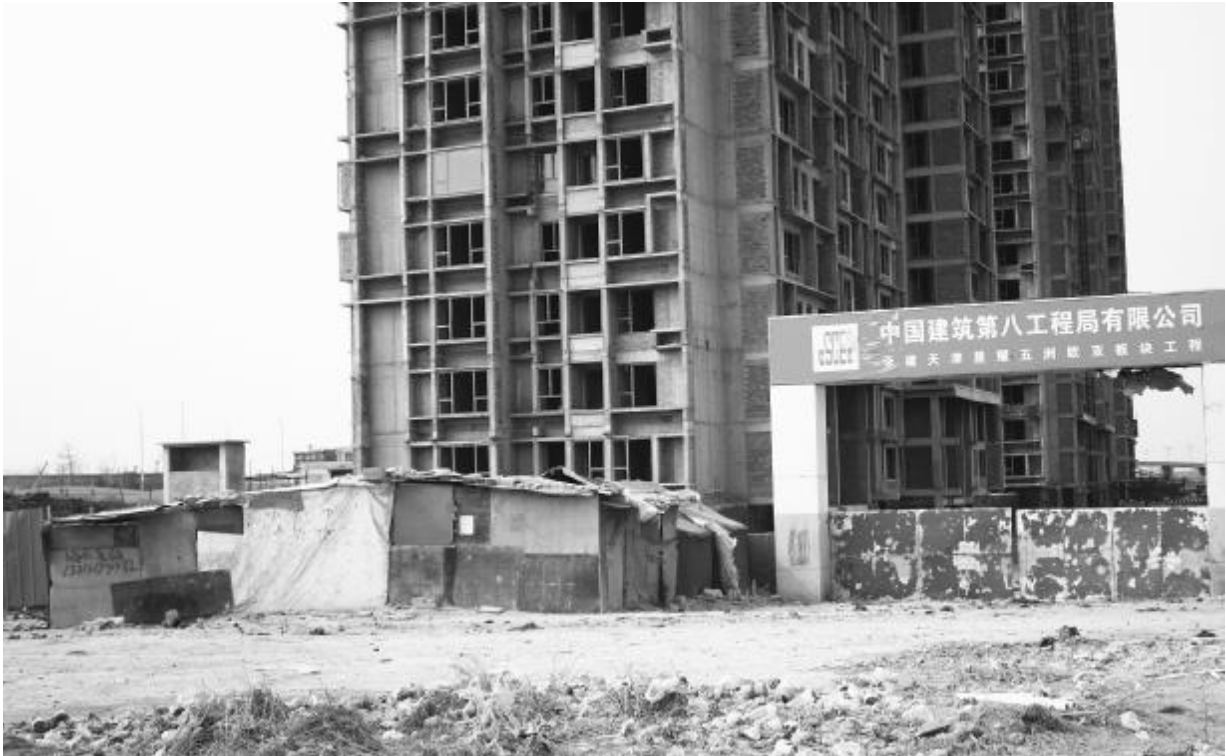
应2011年年底交工、目前仍停工的星耀五洲二期工地
