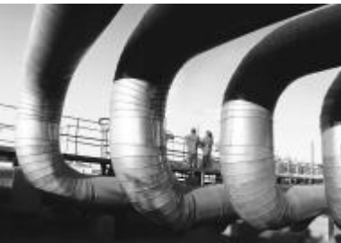
中国石油管道公司工作人员在巡检 孙兆光摄影
