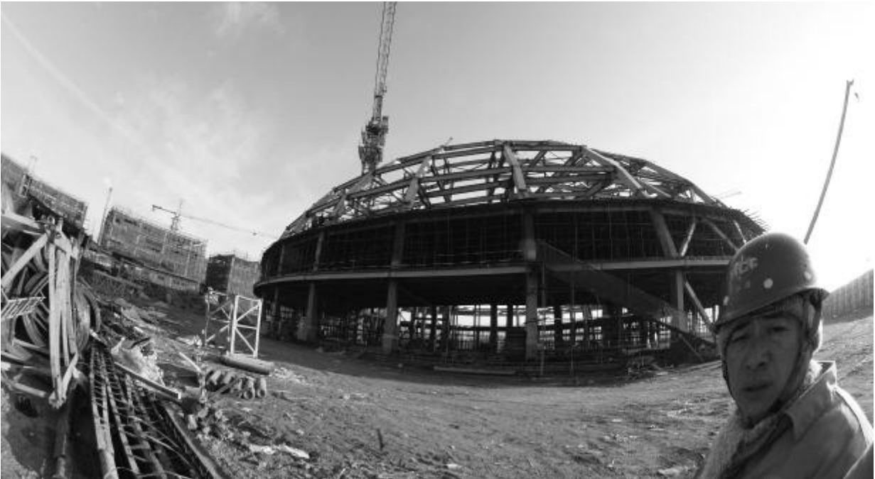
投入巨资兴建的鄂尔多斯低碳谷写字楼主体工程陷入停工状态,除个别留守人员外,工地空空荡荡。 本报记者 任正直/摄
