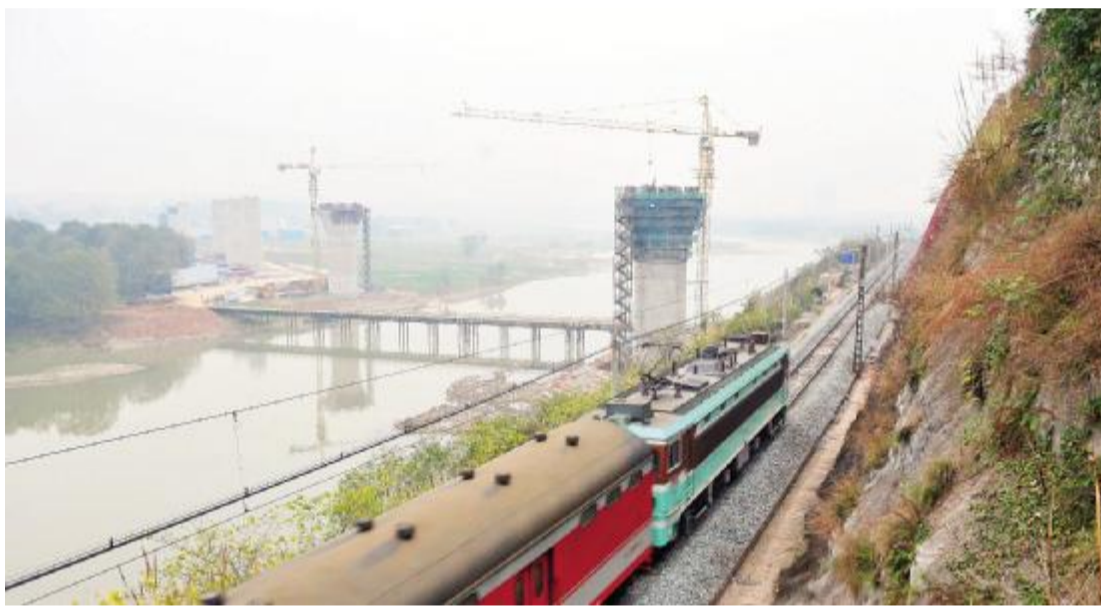
截至 12 月 15 日, 成渝铁路客运专线 2011 年完成投资 73.75 亿元, 占调整后的年度计划 87 亿元的 84.77%。目前, 成渝铁路客运专线全线工程建设有序推进, 为 2012 年成渝客专建设科学有序推进打下良好基础。 CNS 供图
