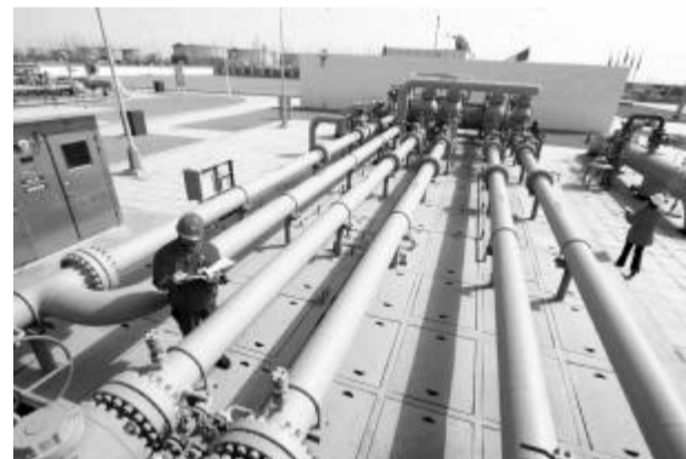
塔克拉玛干沙漠中的中石油“西气东输”首站 CNS 供图
