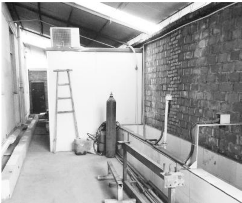
已经废弃的污水处理设备
