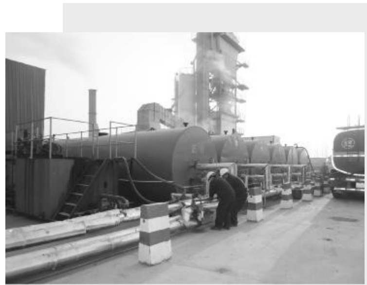
该公司占地200余亩国内领先大型高等级路面施工沥青拌合站一角
