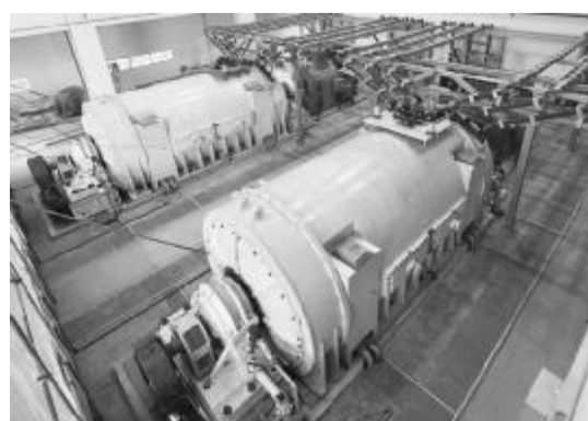
2x3500MVA冲击发电机系统
