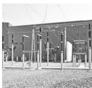
220kV网络试验系统
