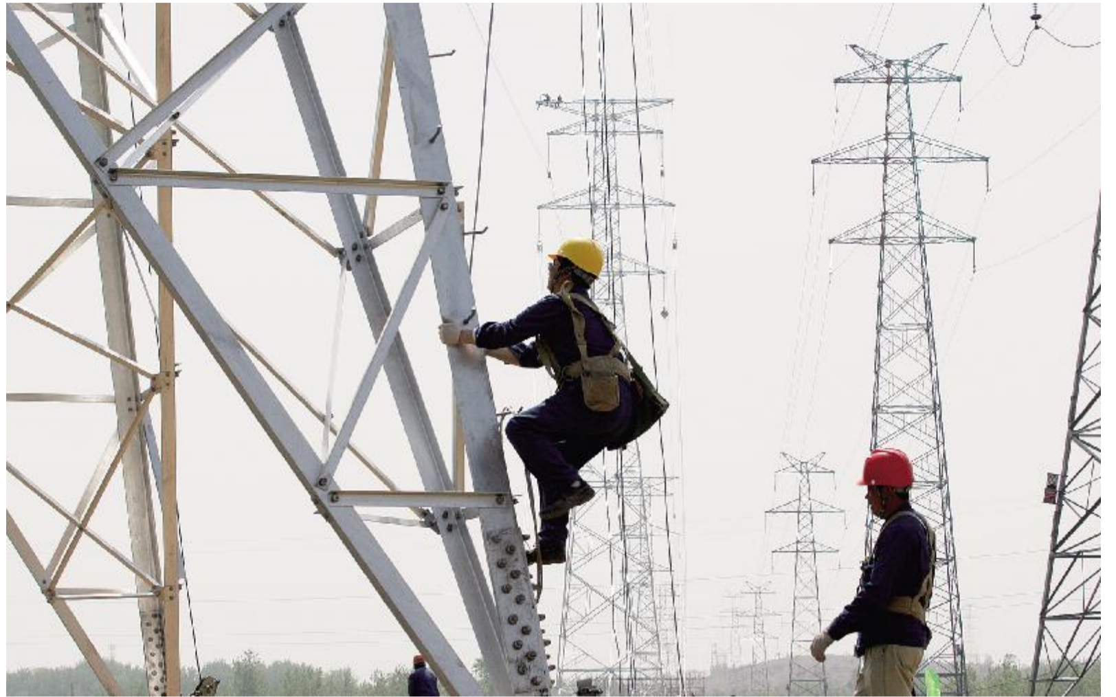
图为安徽电网2011年迎峰度夏一号工程“淮五线”220千伏输电线路技术改造施工现场。CFP供图
